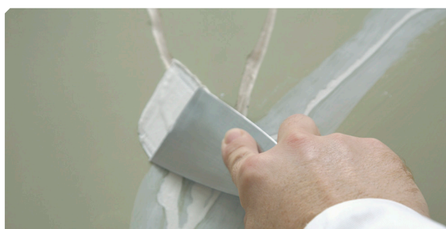
■ Fessure superiori a 2 mm. trattate con stucco elastico
